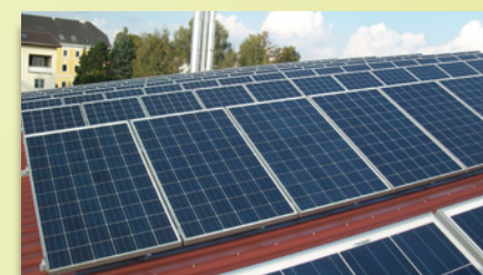
Die PV-Anlage am Dach des Heizwerks
